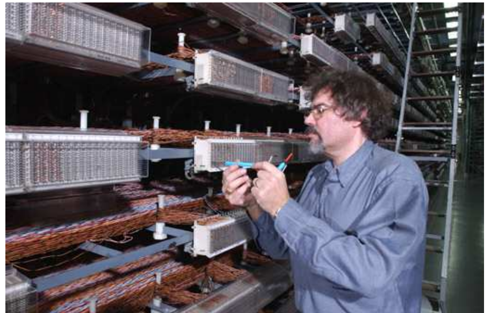
Les jarretières dans les répartiteurs
