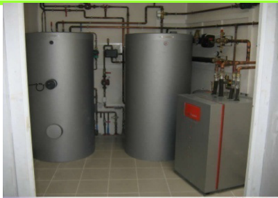
Pompe à chaleur
