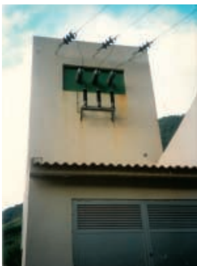
Départ vers le réseau en HTA
