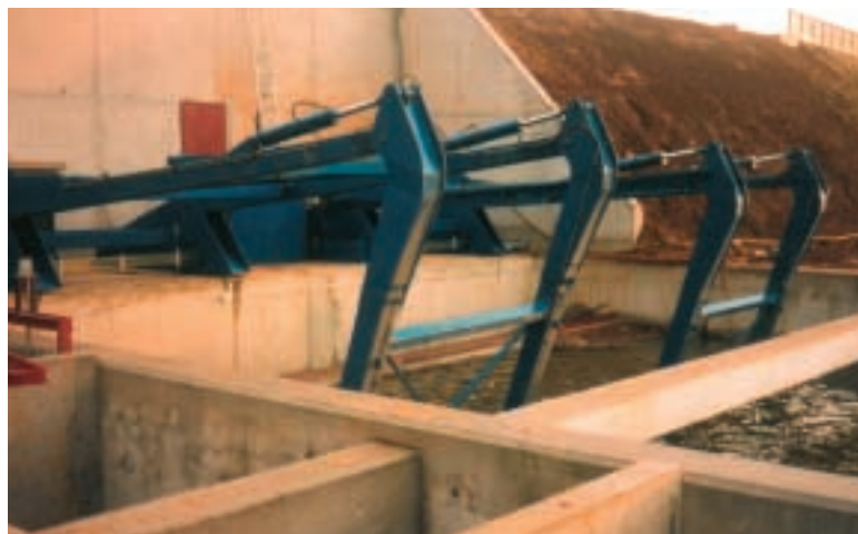
Rateaux dégrilleurs hydrauliques en action.
