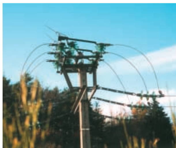
Interrupteur 20 000 volts en tête de poteau
